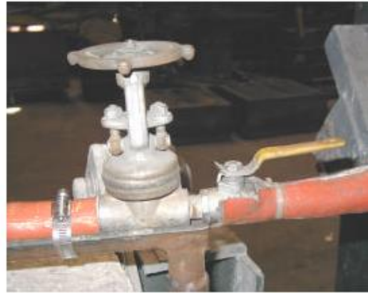
图 8-4 闸阀、球阀和输气管道
